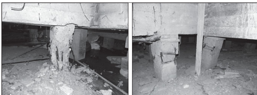
Рис. 5. Аварийное состояние свай в помещении технического подполья
